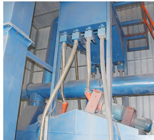
抛丸除锈机 Shot blasting machine
